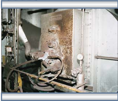
Les brûleurs s'adaptent aux équipements existants.
